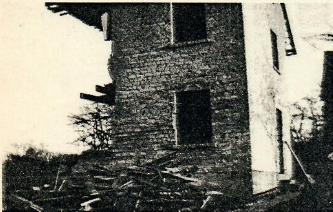
Das Haus Boes, später Siebert, Westumer Straße, wurde am 5.1.1944 durch Bombenabwurf zerstört. Foto: Archiv Schmalz
